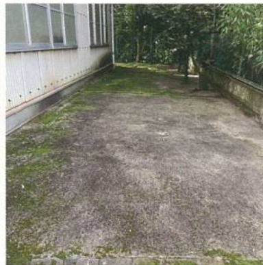
10年前施工 ソイル40m/m 日陰の場合、コケが生える場合があります
